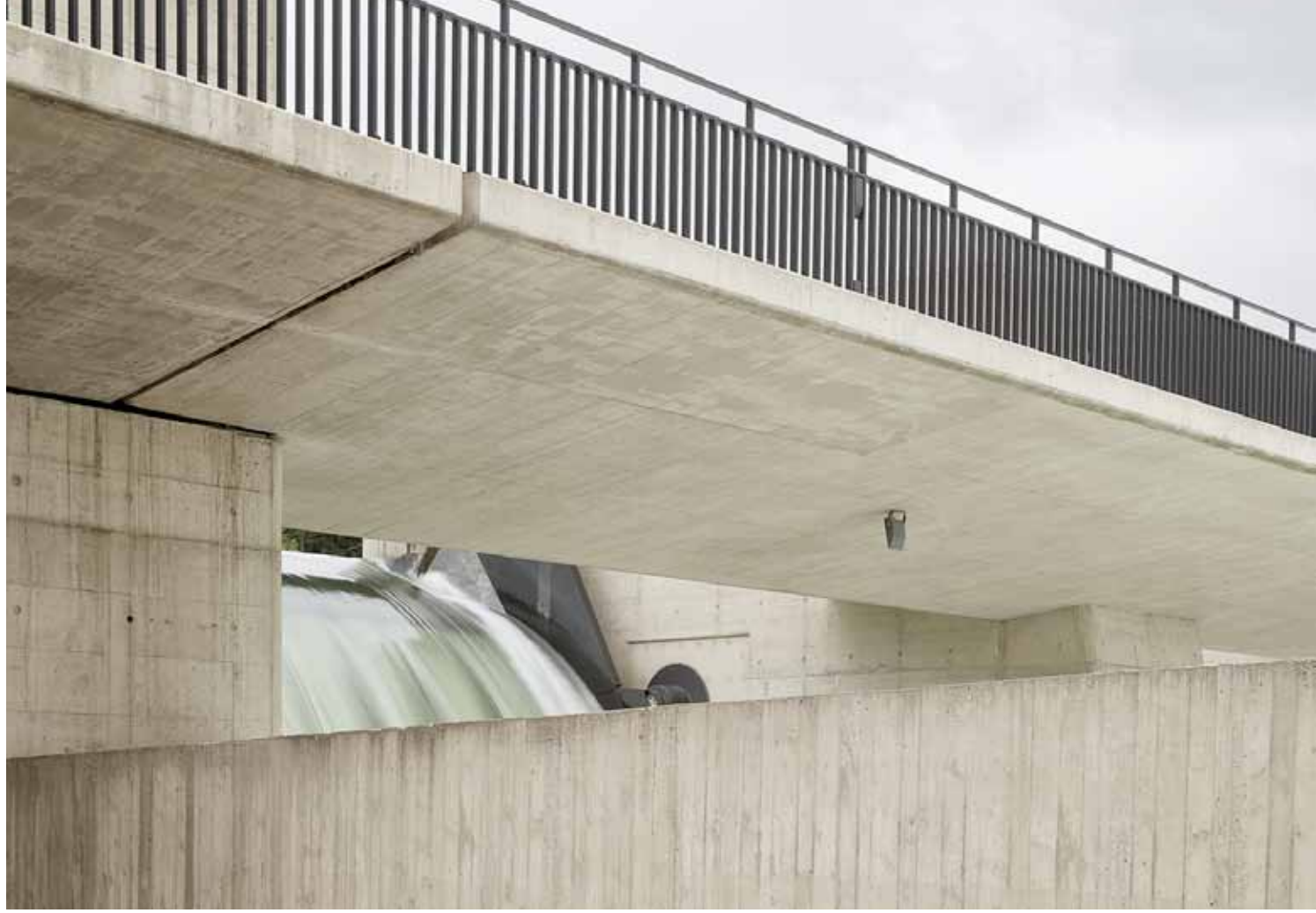
Betonoberflächen und Kantennähen
